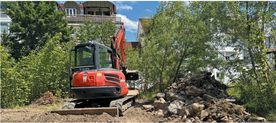
Schweres Gerät rückte an, um für die Bevölkerung ein Stückchen Natur in die Stadt zurückzuholen.
